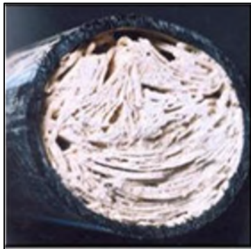
Photo 1 : Conduite enPVC d'eau potable
