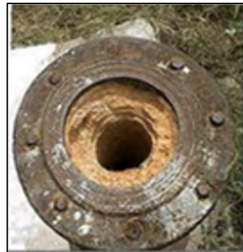
Photo 2 : Conduite métallique entartrée
