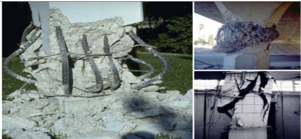
Figure II.18 : Rupture par flambement de poteaux.
