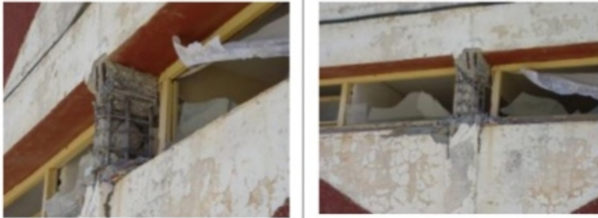
Figure II.22 : Rupture par cisaillement du poteau court (séisme de Boumerdes) [48]..
