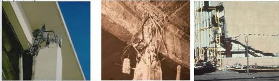
Figure II.19 : Rupture fragile de zone critique non traitées par les armatures appropriées [49].
