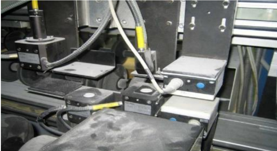
Figure IV.15 : Le système de mesure in situ [17].
