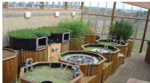
Figure 74 : Living machines, la station d'épuration
