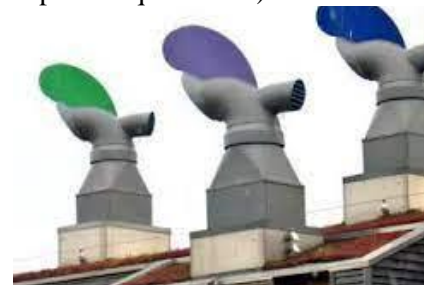
Figure 78 : le système de cheminé utiliser pour la ventilation
