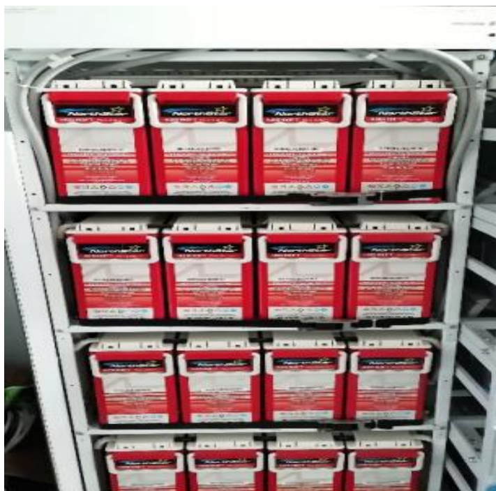
Figure II. 8 : Banc de batterie
