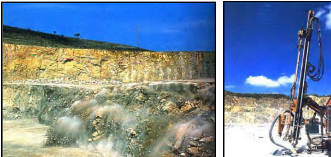
Photo I.11 et I.12. Photo à droite présente un chariot de forage et la photo à gauche illustre l'effet d'un tir de mine.
