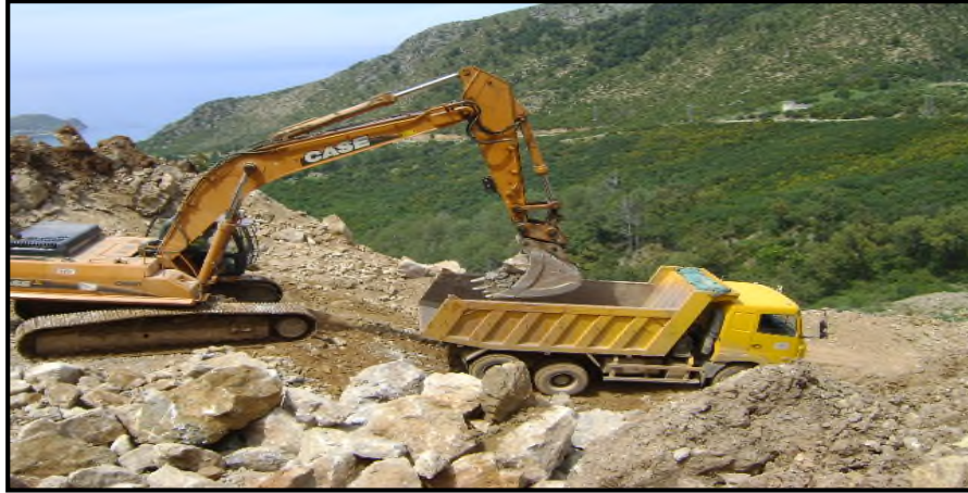
Photo I.13. Photo illustrant le chargement et le transport des enrochements vers les stations de traitement.
