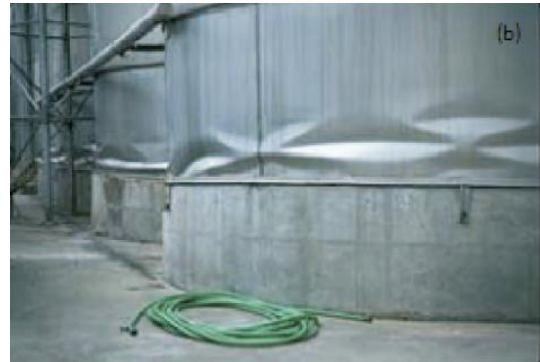
Figure 2. Flambement au sommet des murs (due au ballotement).
