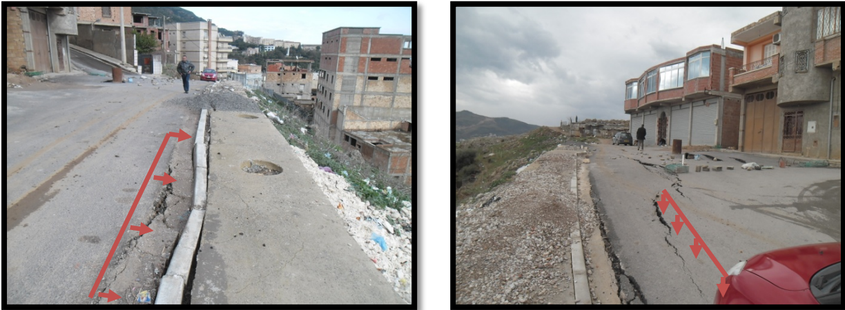
Figure II-6: Fissures et ruptures de la chaussée.
