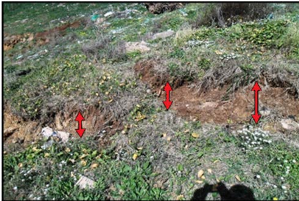
Figure II-7 : Escarpements au niveau du talus aval
