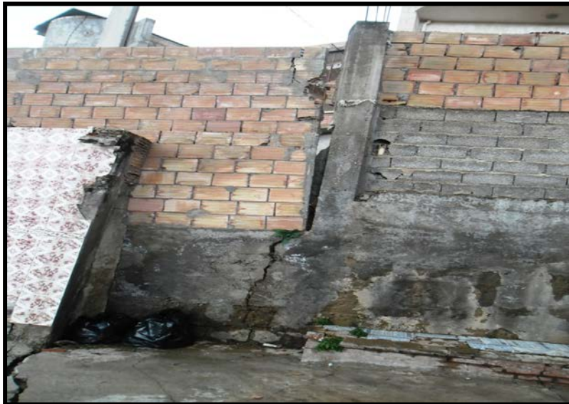
Figure II-5 : Fissuration et décrochement d'un mur de clôture [Avril2016]
