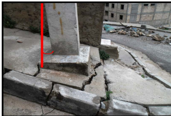
Figure II-3 : Inclinaison d'un poteau électrique [Avril 2016].
