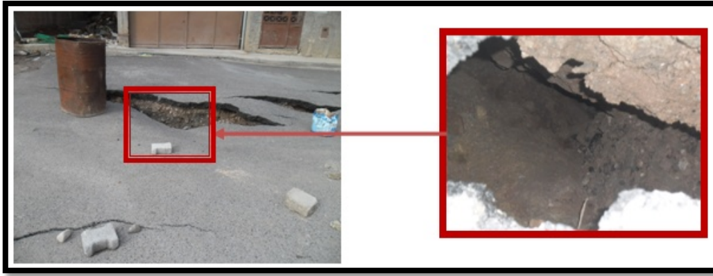
Figure II-8 : Des cavités sous la chaussée.
