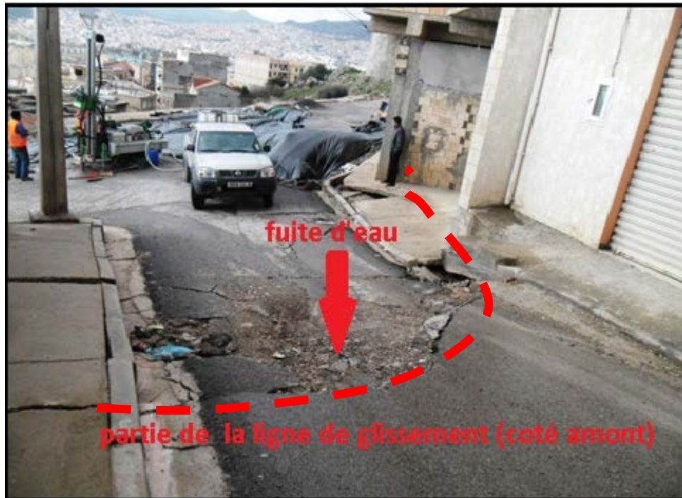
Figure II-4 : Limite de glissement (côté amont). [Avril 2016].
