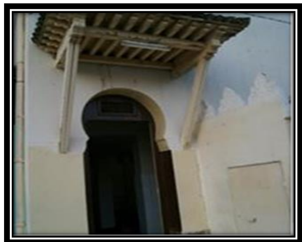
Figure 62 : la porte d'accès a la salle de prière pour femme. Source : auteurs, 2016
