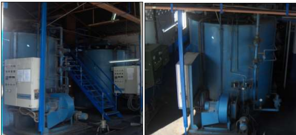
Photo n°6 : Chaudière à huile
