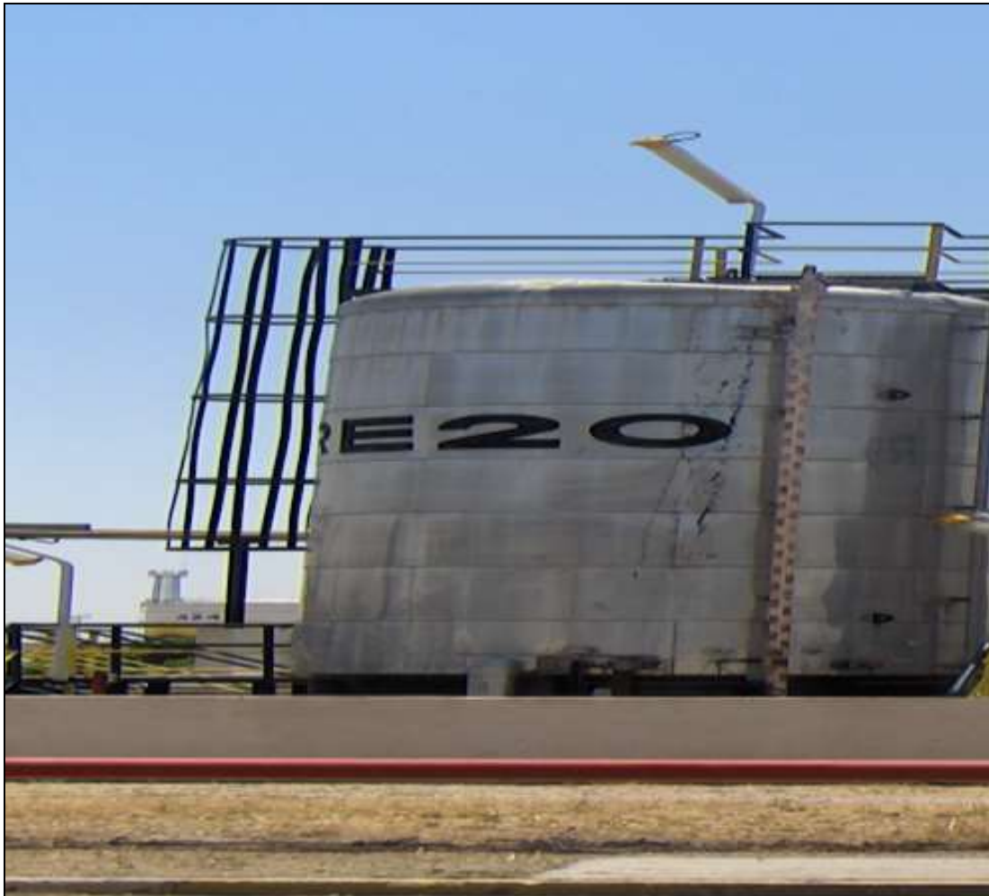
Photo n°5 : Cuves de stockage de bitume
