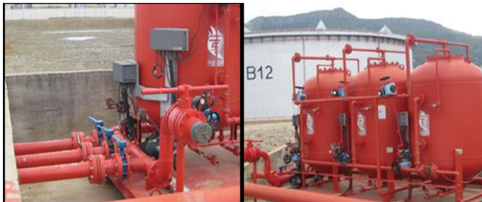
FIGURE 1.9 – Unité de stockage et de dosage d'émulseur
