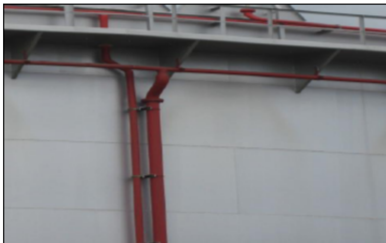
FIGURE 1.8 – Couronne de refroidissement
