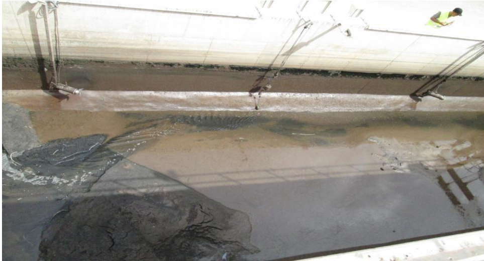
Figure 9 : Le bassin de coagulation-floculation (vue de haut)
