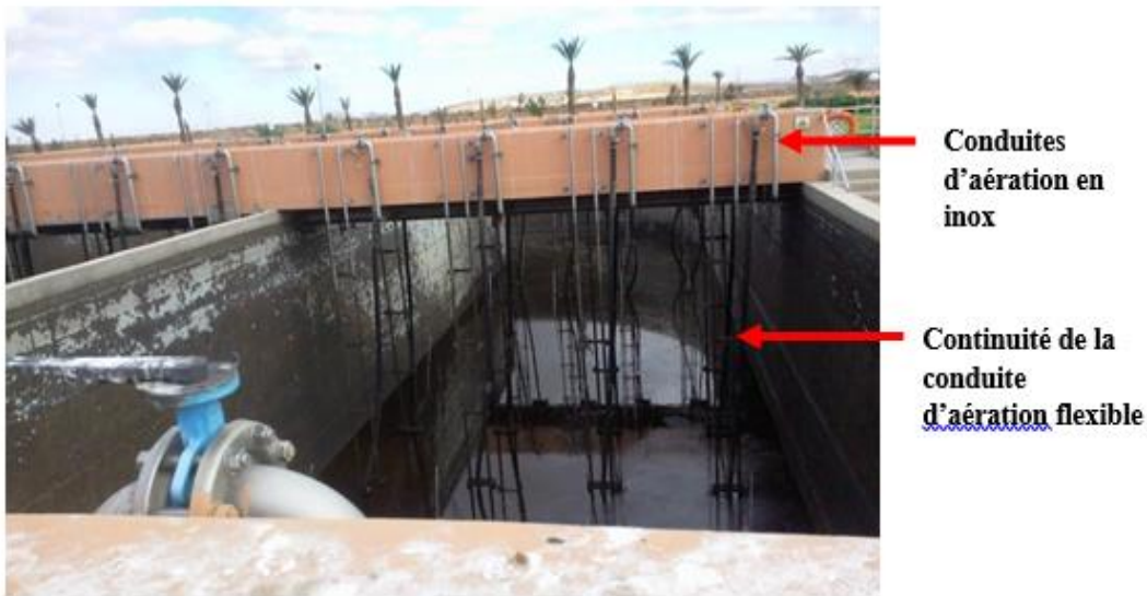
Figure 11. Le bassin d'aération vide [11]
