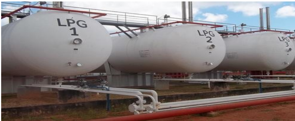
Figure II.3 : présentation d'une citerne de stockage GPL [1]
