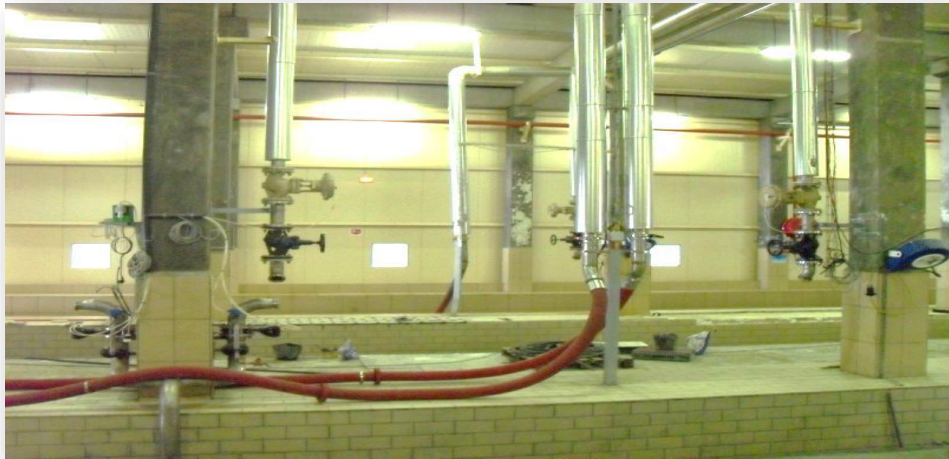
Figure I.6.1 Quai de chargement
