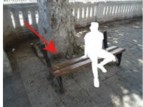
Figure 52:vue sur un banc dégradé Source : (Mansouri, 2018)
