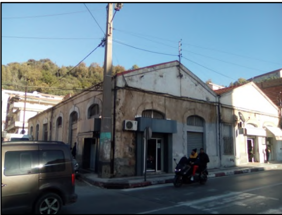
Figure 44:vue sur l'état dégradé des façades du bâti ancien. Source (auteur 2021).
