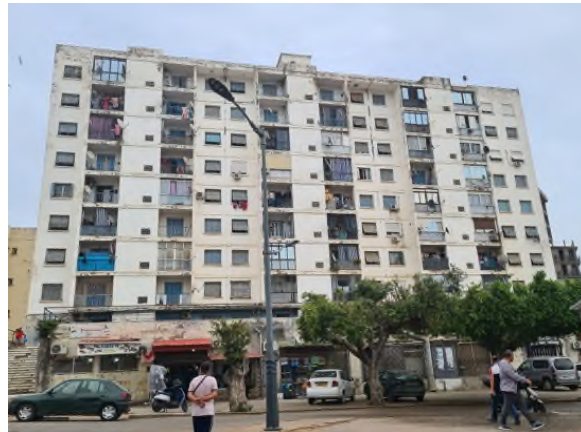
Figure 46:vue sur l'état de la façade moyennement dégradé de la prison d'El Khmis. Source (auteur 2021).
