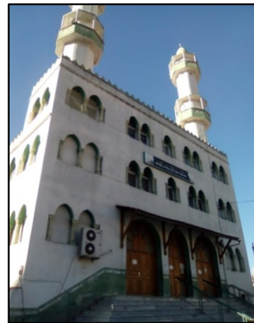
Figure 43:vue sur l'état de la façade moyennement dégradé de la mosquée Ibn Badis. Source (auteur 2021).
