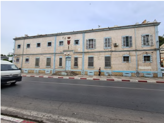
Figure 45:vue sur l'état de la façade moyennement dégradé de barre les Babors Source (auteur 2021).
