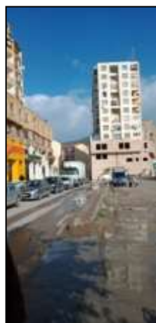
Figure 88: Dégradation de l'état des routes
