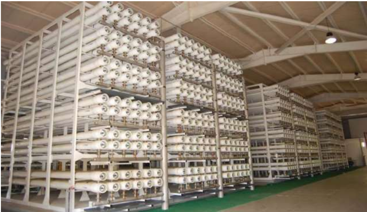
Figure II.5 : Les racks d'osmose inverse de la station (Fouka-Tipaza)
