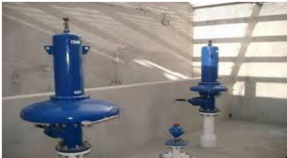
Figure VI.3: Soupape de décharge
