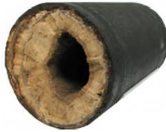
Figure 1 : Phénomène d'entartrage sur les canalisations ( Koriba ,2007 ).
