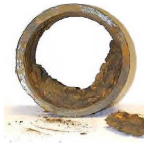
Figure 2 : La corrosion des tuyauteries ( Landolt, 2003 ).
