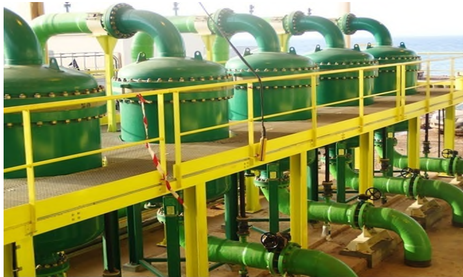
Figure III.5: Filtres à cartouches [Photo prise au niveau de la station de dessalement de Ténès 2017].
