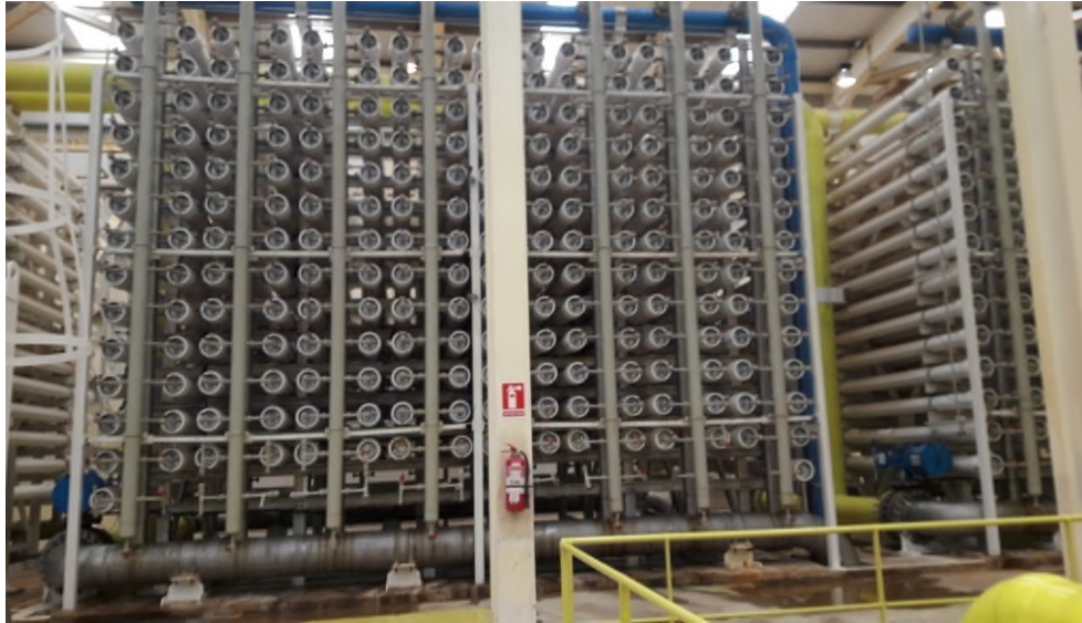
Figure III.6: Un rack dans le système d'Osмосe Inverse [Photo prise au niveau de la station de dessalement de Ténès 2017].
