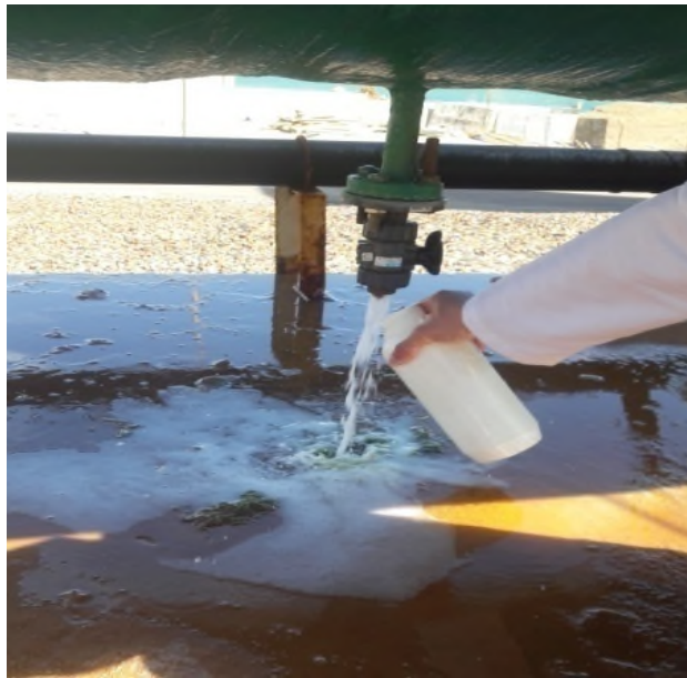
Figure III.8 : Le point de prélèvement de l'eau mer. [Photo prise au niveau de la station de dessalement de Ténès 2017].
