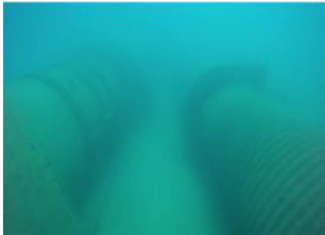
Figure III.3: Tuyaux de captage de l'eau de mer.
