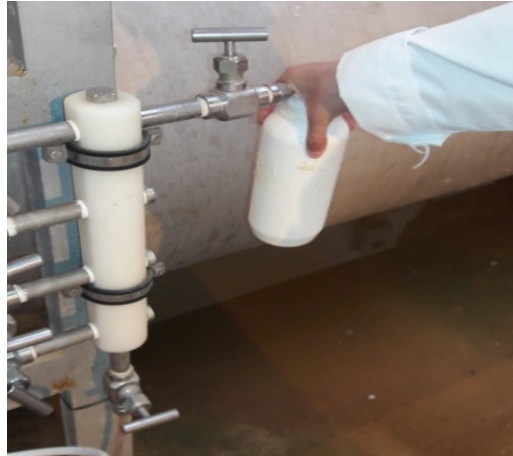
Figure III.9: Le point de prélèvement de l'eau produite [Photo prise au niveau de la station de dessalement de Ténès 2017].
