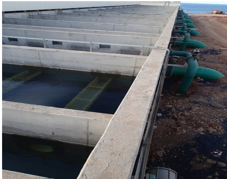
Figure III.4: Filtres à sables [Photo prise au niveau de la station de dessalement de Ténès 2017].
