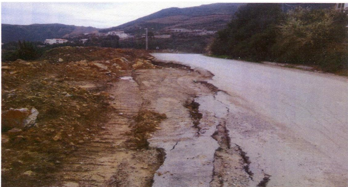
Figure 1: Rupture de la chaussée
