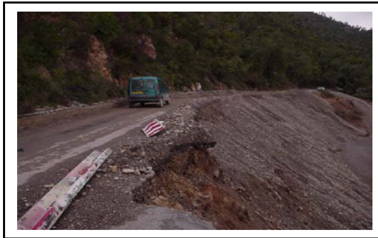
Photo. VI.1 : Vue du glissement.
