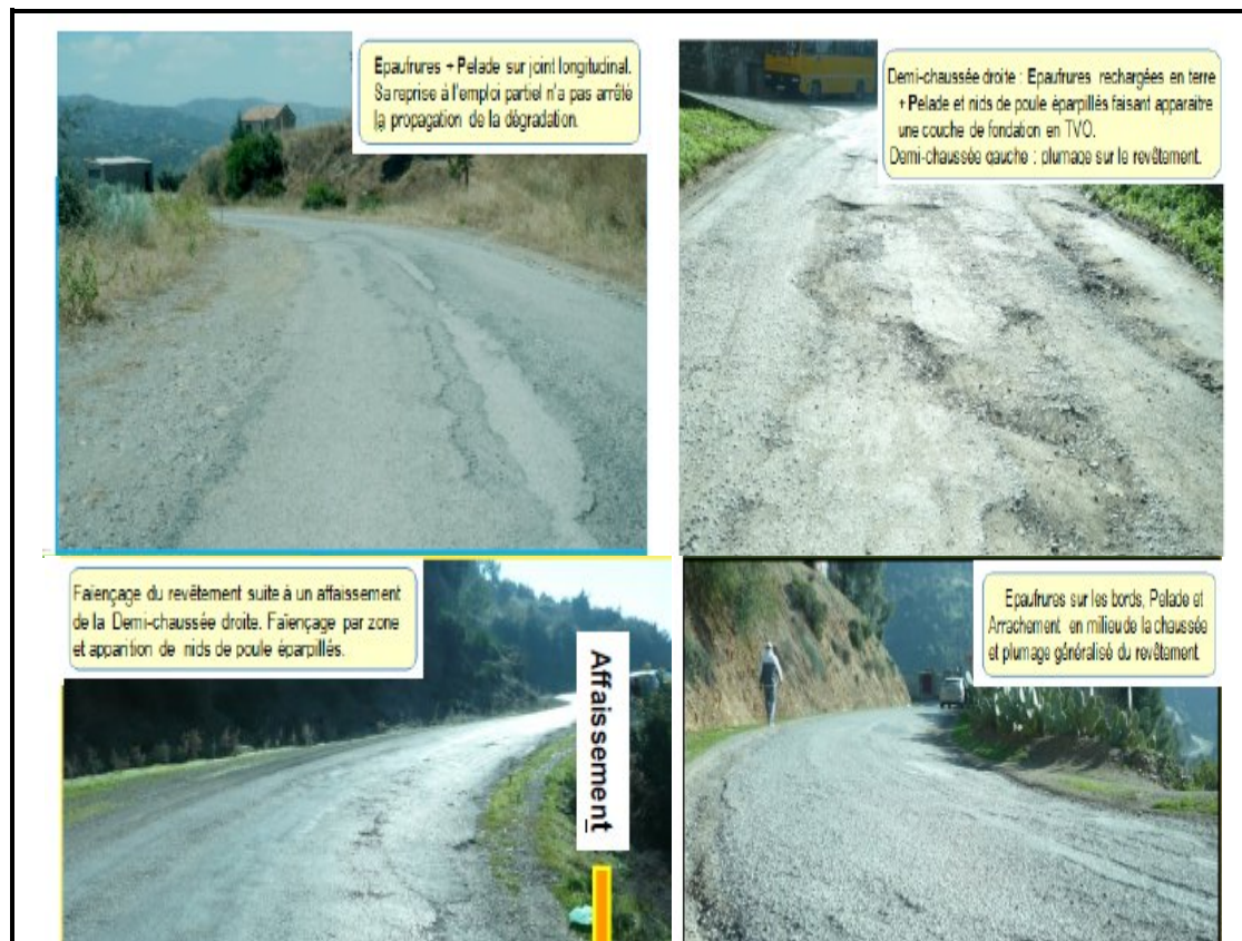
Figure .III.2: Quelque exemple de la dégradation.
