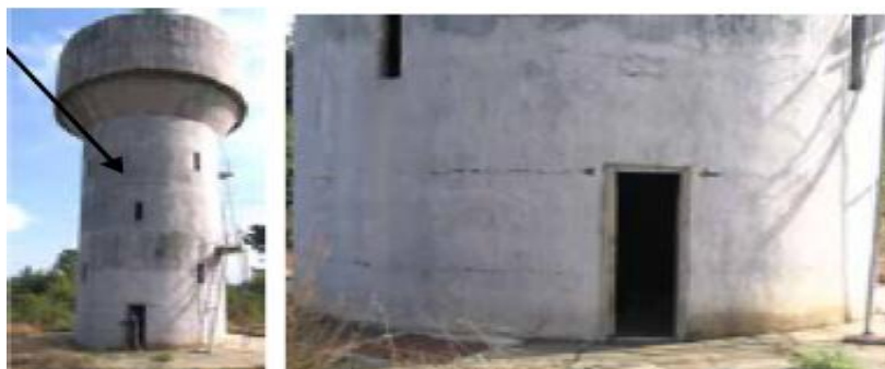
Fig. I. 12. Réservoir surélevé endommagé, 2005 à Kashmir Inde.
