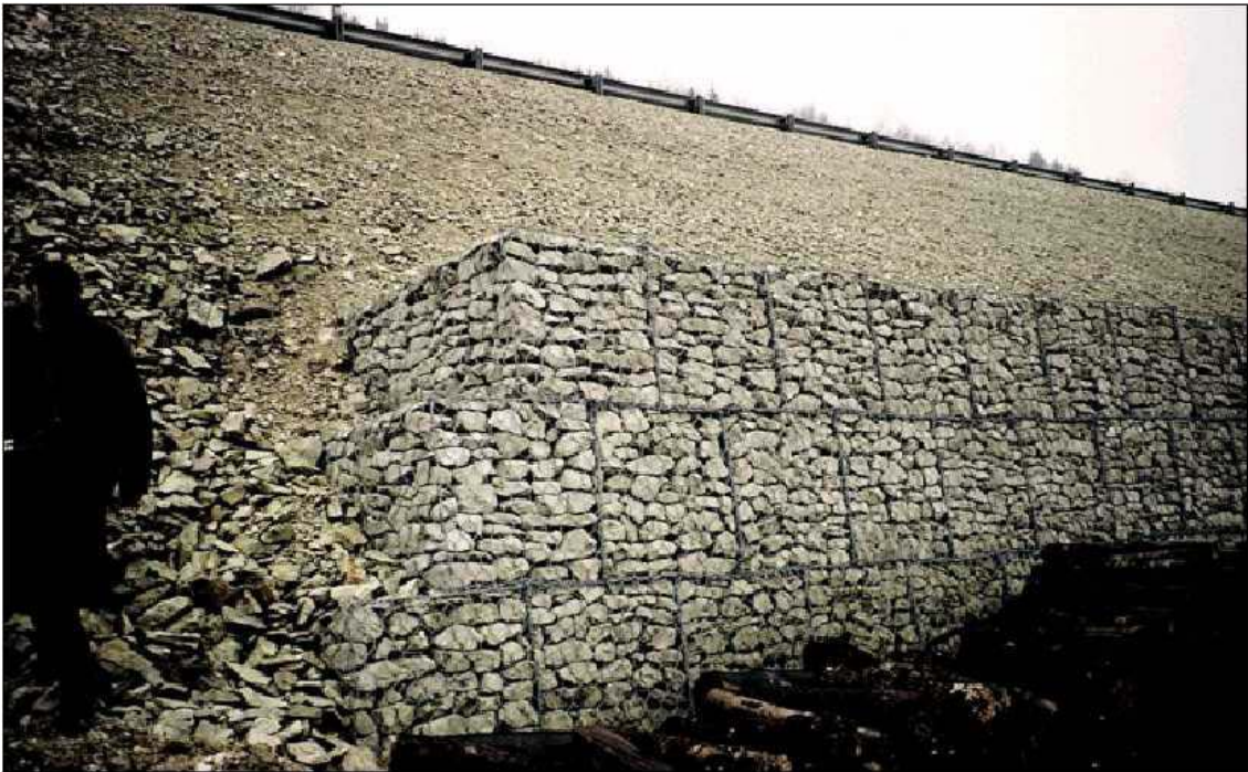
Figure IV.12 : Exemple d'ouvrage souple : Mur en gabion (Service d'Etude Technique des Routes et Autoroutes (SETRA)).
