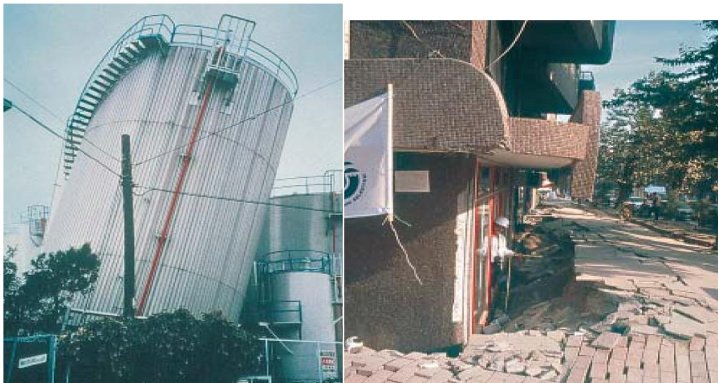
Figure 1 .07.a. Ce réservoir s'est également incliné. Il s'est avéré que le mouvement était dû à la liquéfaction d'un remblai sableux (Kobe, Japon, 1995).
