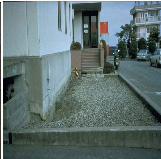
b- Séisme de Kobé, 1995 [21]
