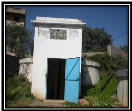
Photo 26: Le réservoir Agoumras vue l'ensemble, manque d'entretien et clôture inexistante.
