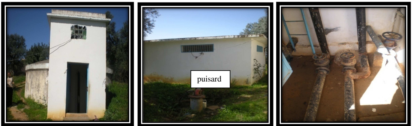
Photo 28: Vue l'ensemble du Réservoir, puisard á ciel ouvert, apparition des signes de corrosion de conduites et vannes .
