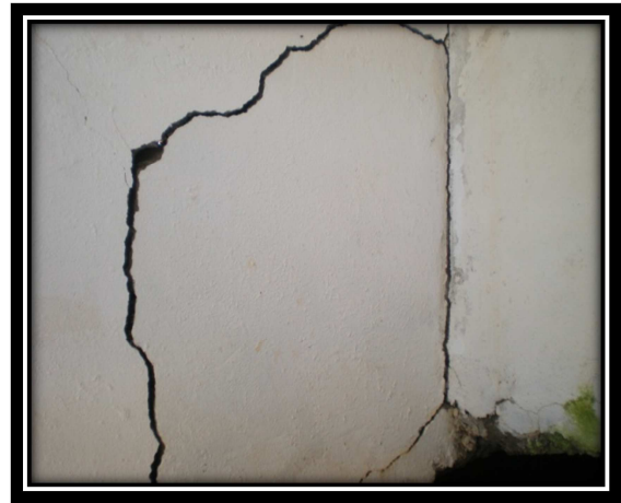
Photo 25: Apparition des fissures sur les murs.
