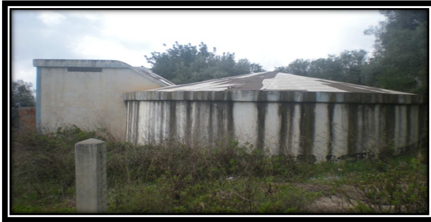
Photo 10 : Etanchéité et clôture inexistante.
