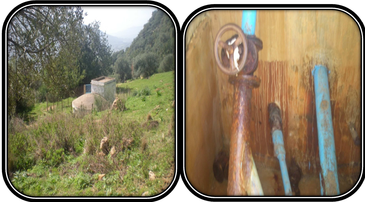
Photo 17: Vue l'ensemble du réservoir, le conduit sortant du réservoir non conforme, fuites, et corrosion très avancée.
