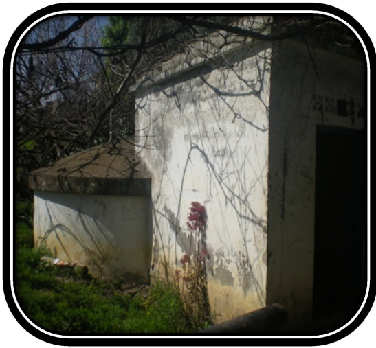
Photo 14 : Manque d'étanchéité et d'entretien.
