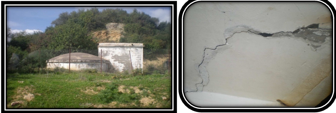
Photo 19: Vue l'ensemble de la chambre de vannes, apparition de fissures sur les murs.
