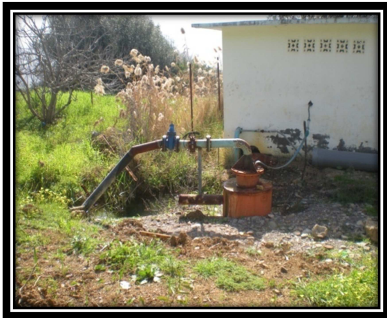
Photo 24: puisard à ciel ouvert, raccordement de la conduite de refoulement non conforme aux normes.
