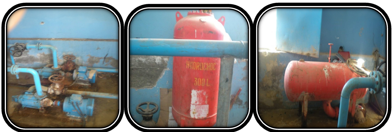
Photo 13 : Le réservoir Avadou vue d'ensemble, manque d'entretien et anti béliet non fonctionnel.
