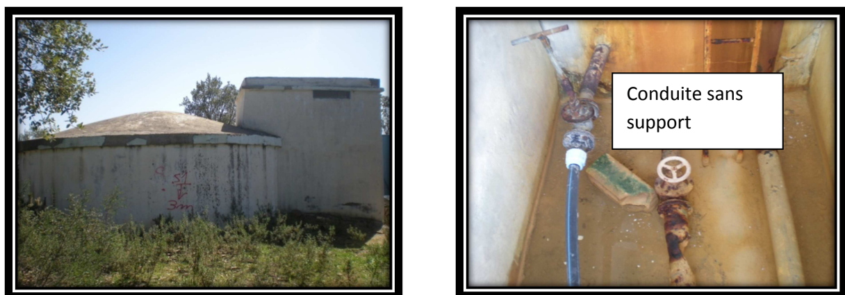
Photo 29: vue d'ensemble du reservoir, manque d'entretien et des conduites sans support.
