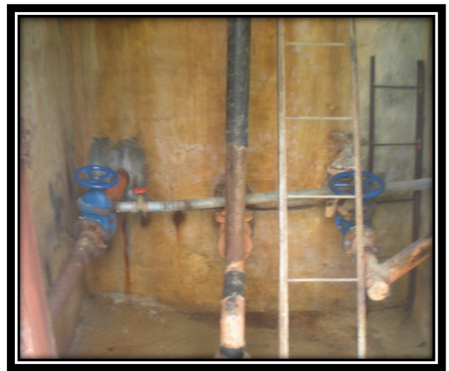
Photo 21 : conduite sortante ne répondant pas aux normes, manque entretien.
