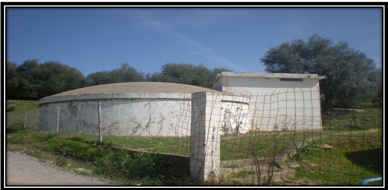
Photo 5 : Réservoir sans clôture et puisard à ciel ouvert.
