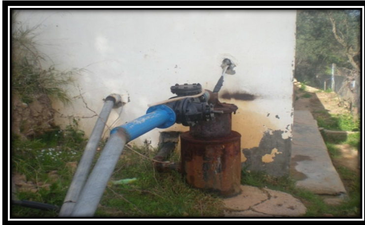
Photo 4 : corrosion du puisard et mal façon dans le raccordement de la conduite.
