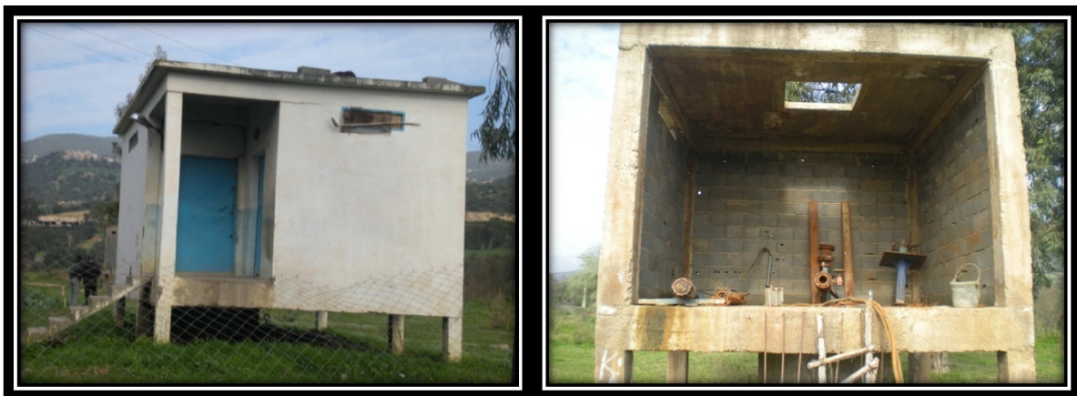
Photo 11 : Abri de forage en service, travaux maçonnerie non achevés, Clôture inexistante, manque entretien.
