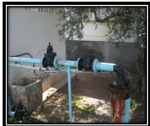
Photo 27 : pompe immergée avec puisard à ciel ouvert.
