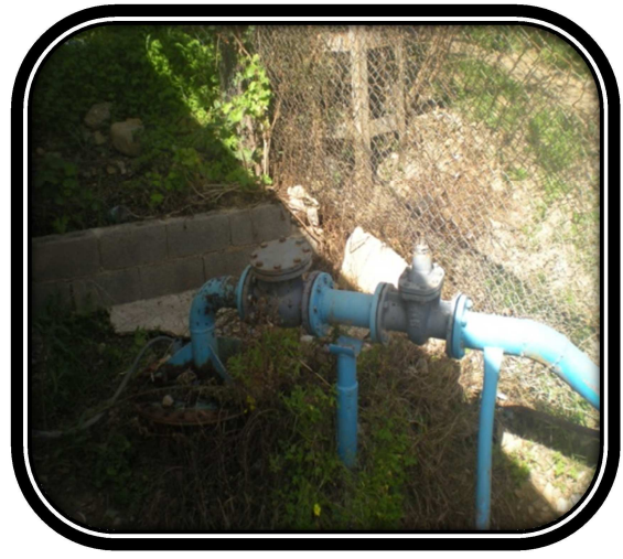
Photo 15 : Pompe immergée avec puisard sans regard de protection, encombrée par la broussaille.
