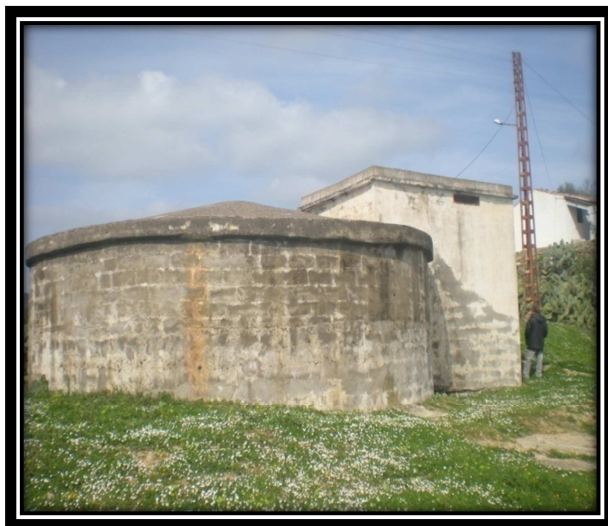
Photo 20 : Vue l'ensemble du réservoir Tighilt Nait Ziane, clôture inexistante.
