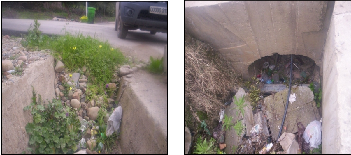
Figure 39: Etat des fossés et regards bétonnés (milieu urbain CW13)
