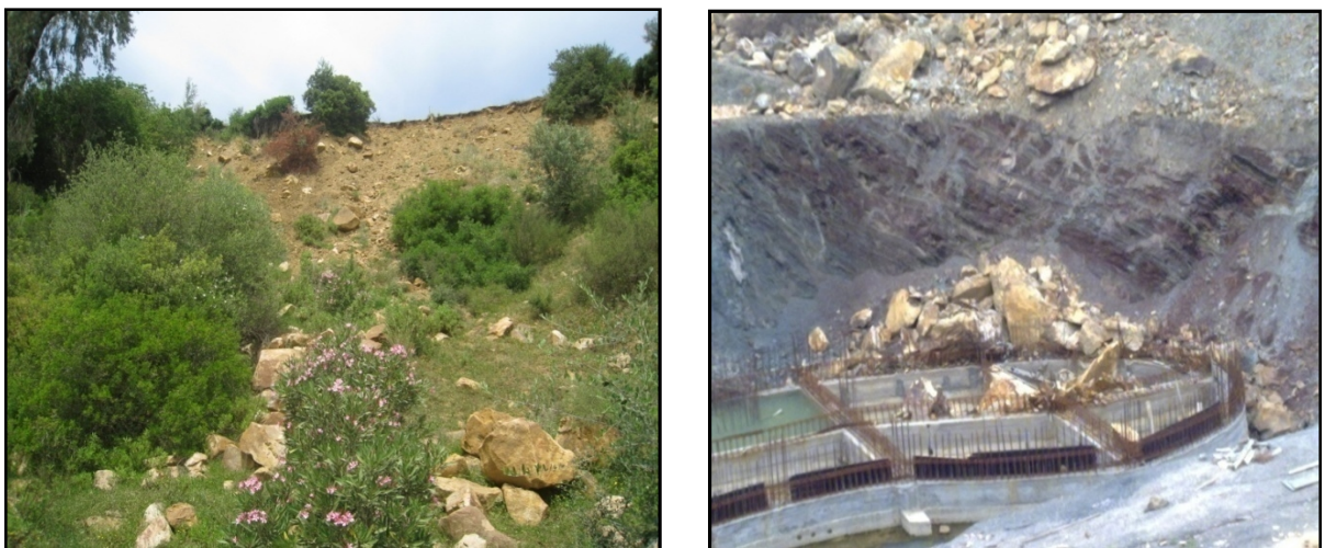
Figure 32: Eboulements et chutes de pierres au niveau de la station thermale
