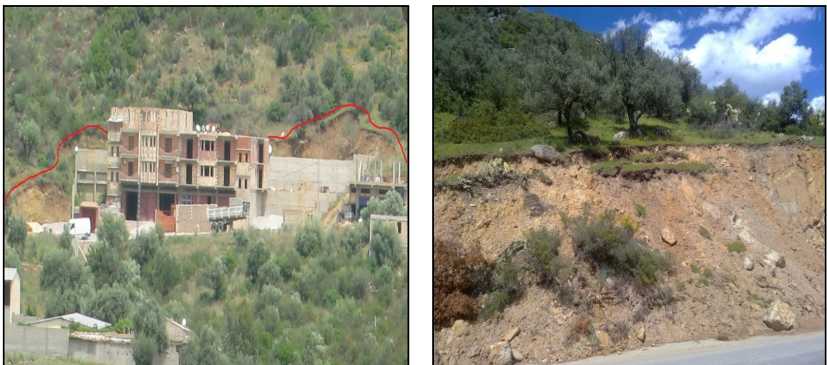
Figure 40: Conséquences des travaux de terrassements et le non soutènement des talus le long de CW13
