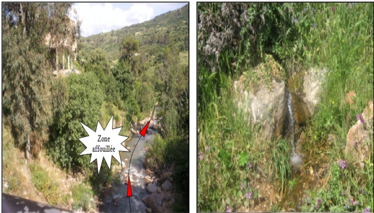
Figure 36: Affouillement des berges le long de l'Oued Remila coté aval de CW13 et abondance des sources naturelles.
