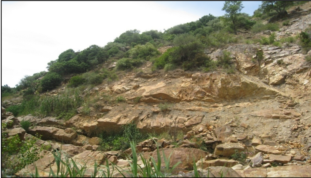
Figure 34: Pentes importantes et éboulement des masses rocheuses au niveau de la station thermale
