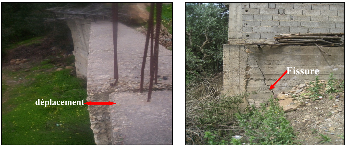
Figure 31: Apparition de fissures sur les habitations et déplacement des murs de soutènement.
