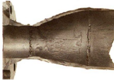
Figure I.6: Corrosion-érosion dans une zone turbulente [11].
