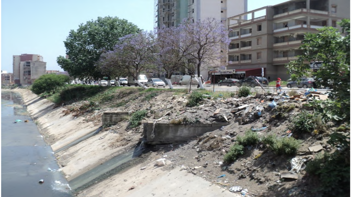
Figure (III-4) : Rejet direct de réseau unitaire dans Oued Serrir.
