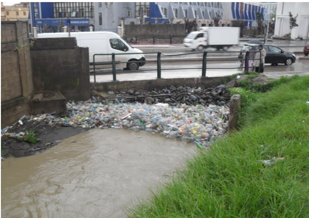
Figure (III-19) : Encombrement d'oued N'dfali.
