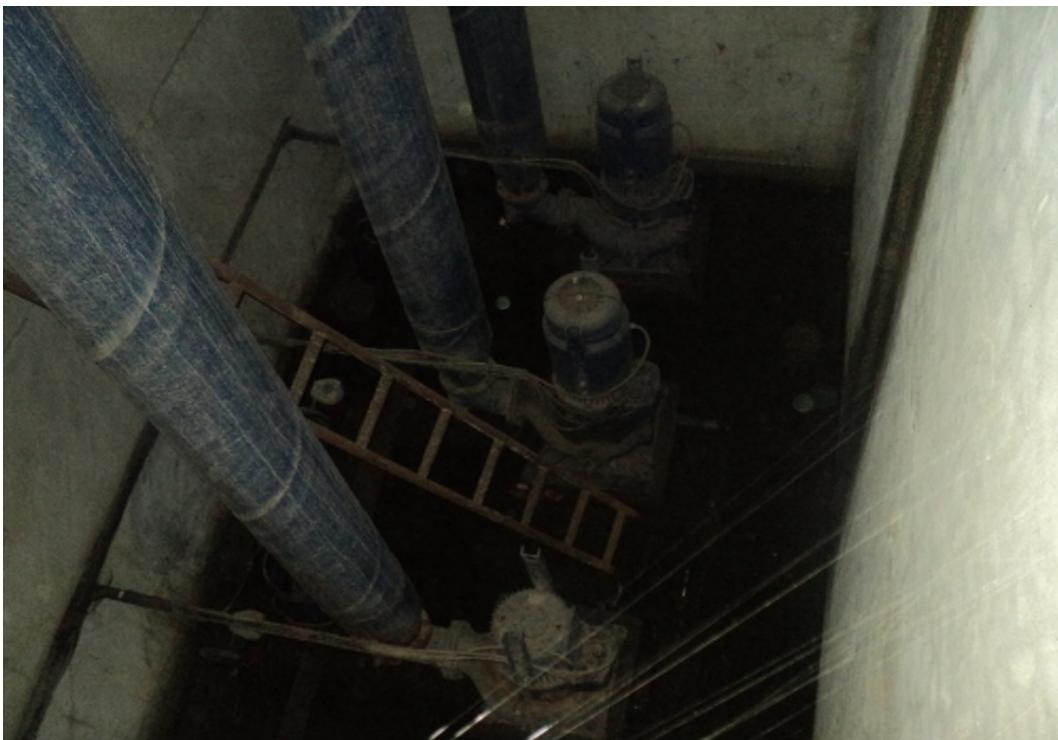
Figure (IV-2) : station de relèvement quatre chemins
