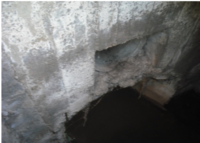
Figure (IV-10) : trop plein (OS 05)
