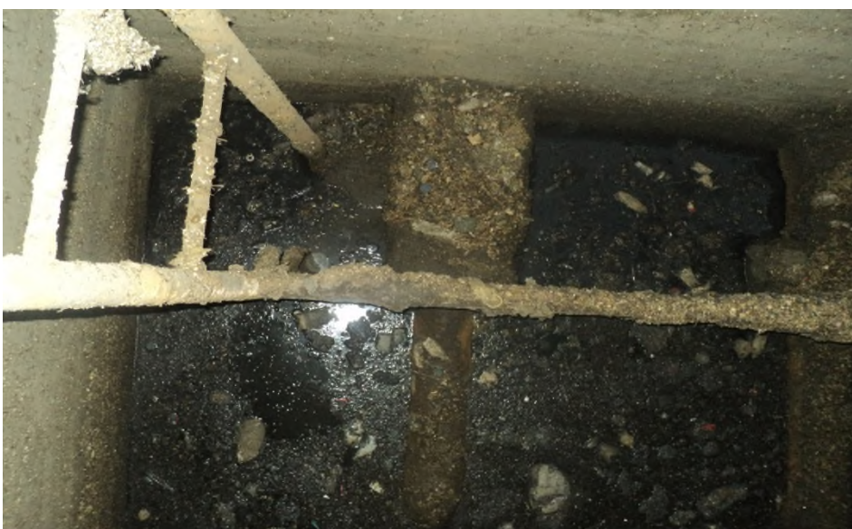
Figure (IV-4) : la bache de la station de refoulement Sidi Ali L'Abhar.
