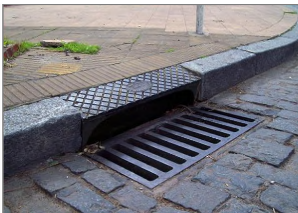
Figure (II-10) : Bouche d'égout à avaloir
