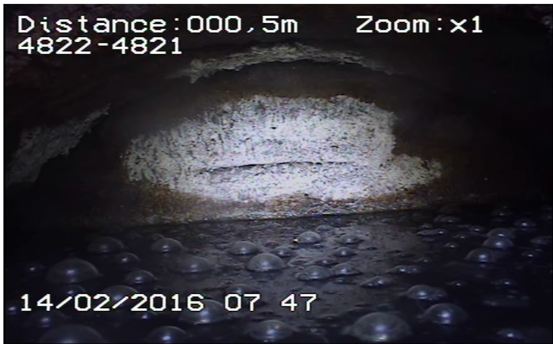
Figure (III-14) : Formation de H 2 S à l'intérieur d'une conduite
