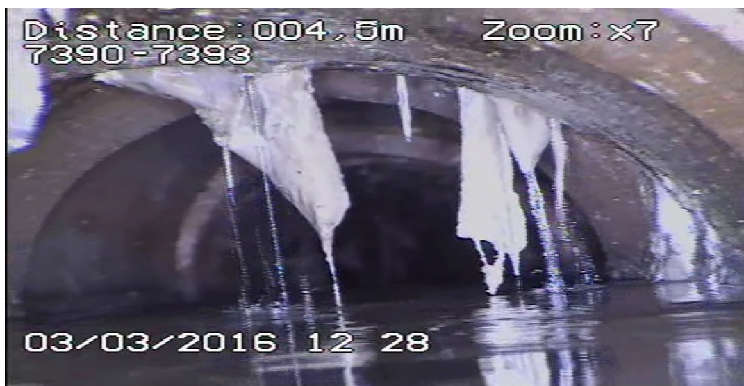
Figure (III-10) : Infiltrations d'eaux claires parasites (Cité Nacéria).
