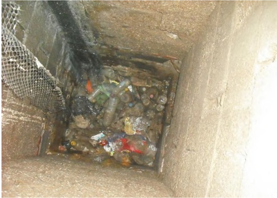
Figure (III-17) : Regard dont les conduites amont et aval sont masquées par les déchets. (Absence d'échelle de descente)
