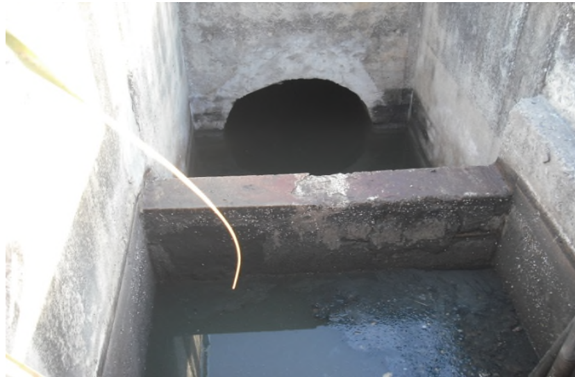
Figure (IV-9) : Déversoir d'orage situé en amont de STEP Centre-ville.
