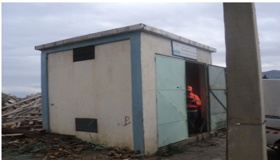
Figure (IV-3) : station de refoulement Sidi Ali L'Abhar.
