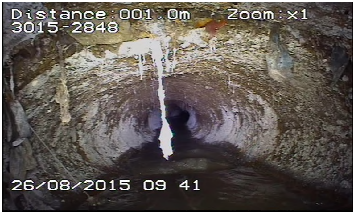
Figure (III-15) : Corrosion des parois en béton d'une conduite.
