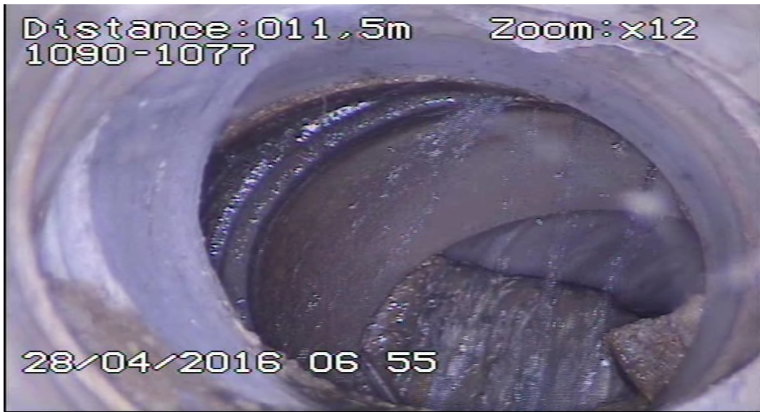
Figure (III-11) : Infiltrations d'eaux claires parasites (Cité Mangin).
