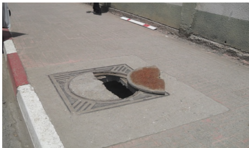
Figure (III-16) : Etat dégradé des tampons des regards. (Route des Aurès).
