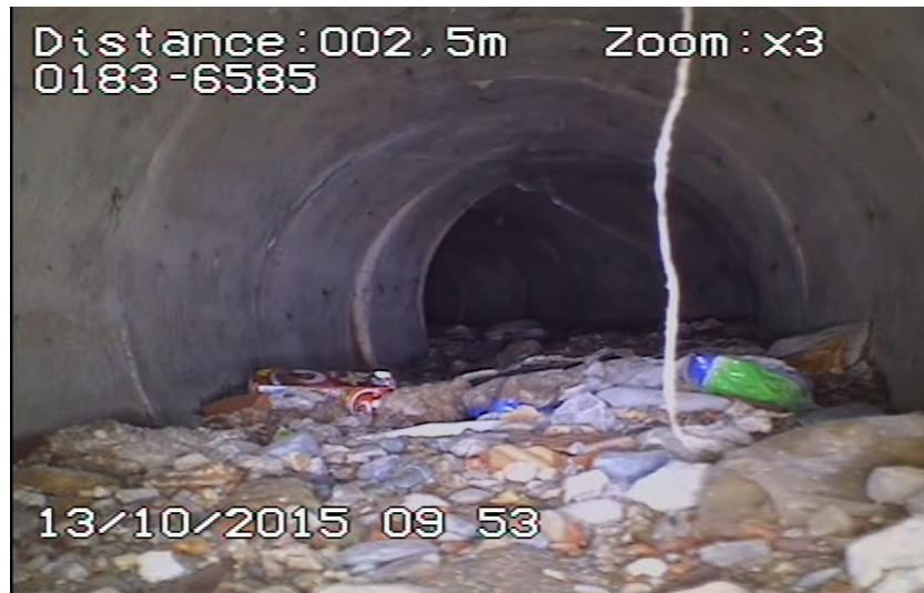
Figure (III-9) : Conduite encombrée par des déchets ménagers et des gravats (cité Djama).
