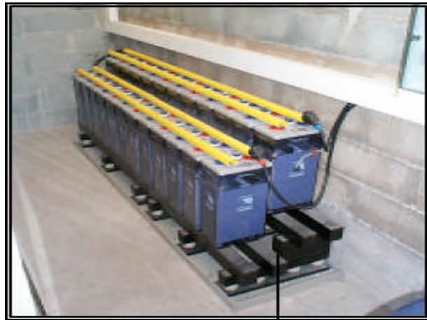
Figure (III.3). Banc des batteries de type NI-Cd [12].
