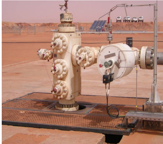
Figure (IV.1). Tête de puits, TG : 04.
