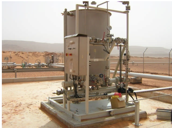
Figure (IV.4). Système d'injection d'inhibiteur de corrosion, TG : 04.
