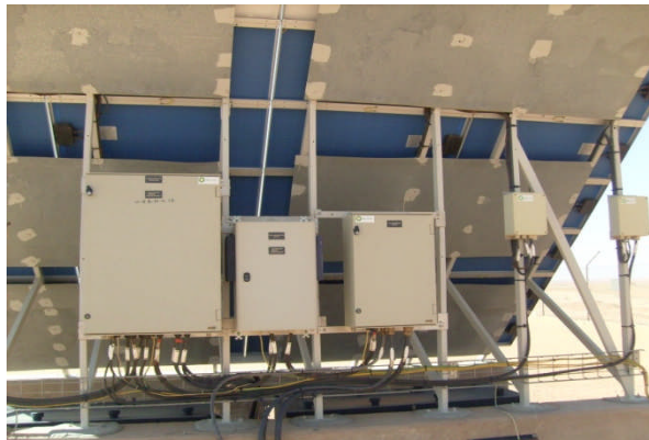
Figure (III.7). Boites de protection et de distribution, TG : 04.
