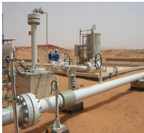
Figure (IV.3). Système pilote local de commande des vannes, TG : 04.
