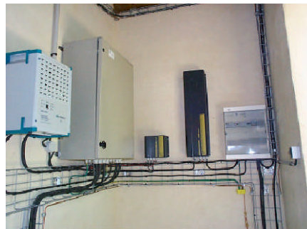
Figure (III.13). Appareils de gestion et de conversion d'énergie.
