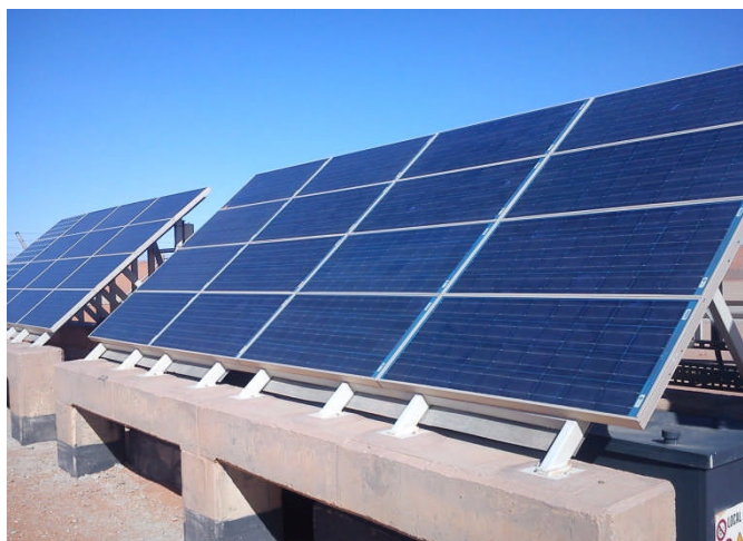
Figure (III.2). Panneaux solaire de type BP-Solar 375, TG:04.
