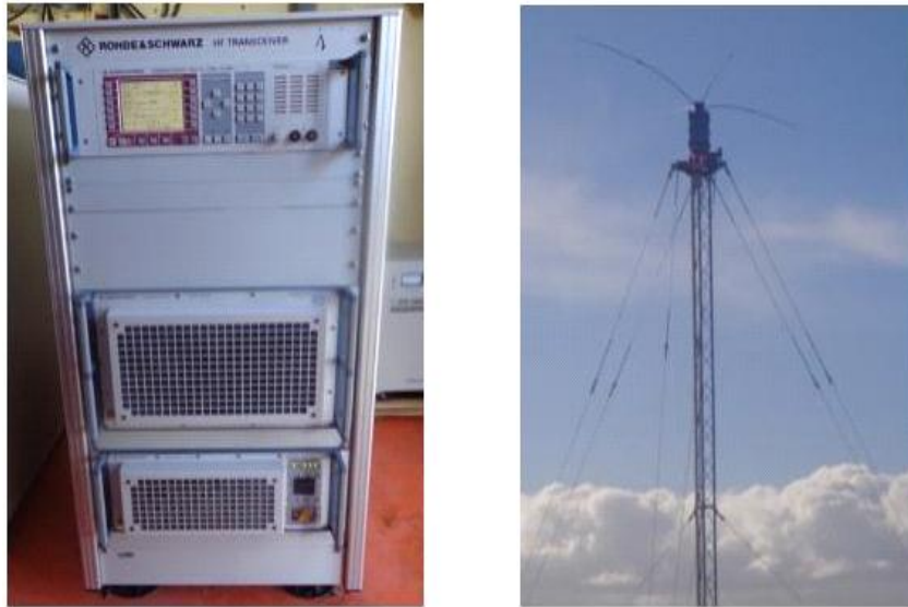
Figure (III.14) : Baie radio HF et son antenne.
