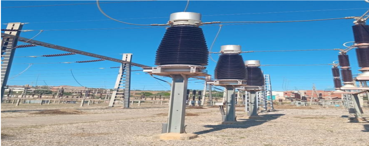
Figure II.13. Transformateur de tension (TP) au niveau du poste d'interconnexion d'elkseur (photo prise en mai 2025).
