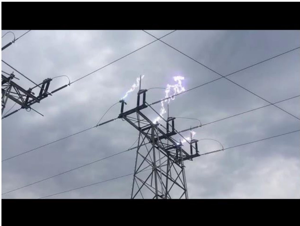
Figure II.1. Exemple réel d'un défaut électrique dans un réseau de transport haute tension
