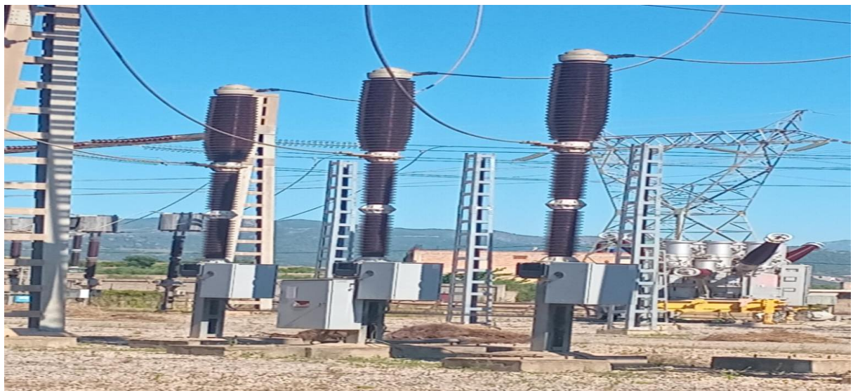
Figure II.14. Disjoncteurs installés au poste d'interconnexion de haute tension à Elkseur (photo prise en mai 2025)
