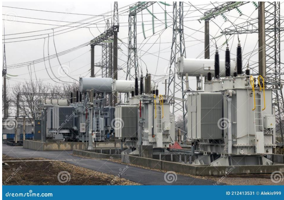
Figure I.4. Transformateur de puissance
