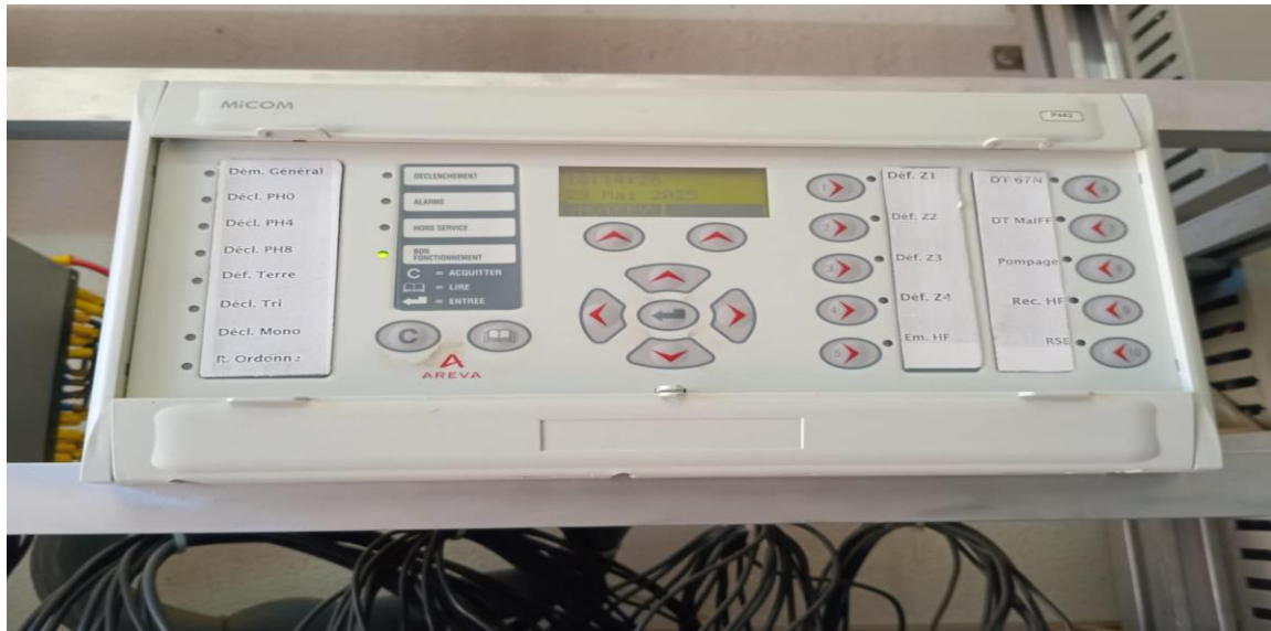
Figure II.18. Relais numérique de protection à distance AREVA MiCOM P442 installé au niveau du poste d'interconnexion d'Elkseur — utilisé pour la protection des lignes de transport haute tension (zones Z1 à Z4)
