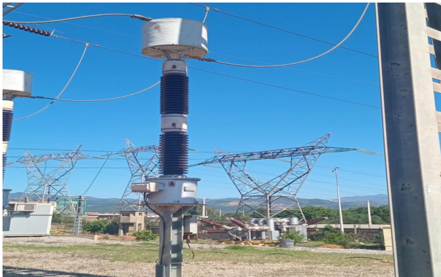
Figure II.12. Transformateur de courant au niveau de poste d'interconnexion de Delkseur
