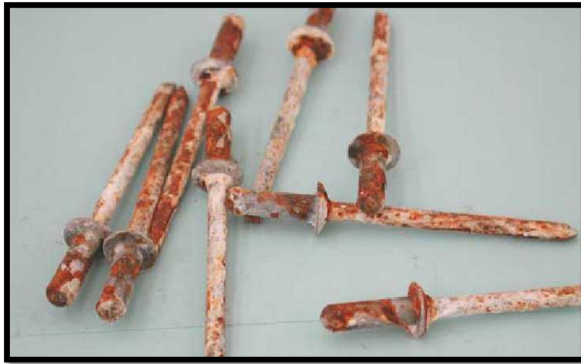
Figure I.2: Corrosion chimique, effets sur les rivets et les inserts.
