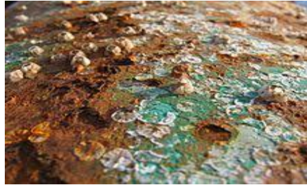
Figure I.2 : Exemple de corrosion chimique
