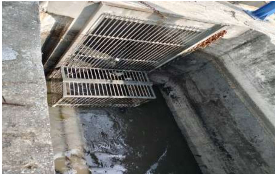
Figure II.3: Photo représentant une grille séparatrice de déchets grossiers
