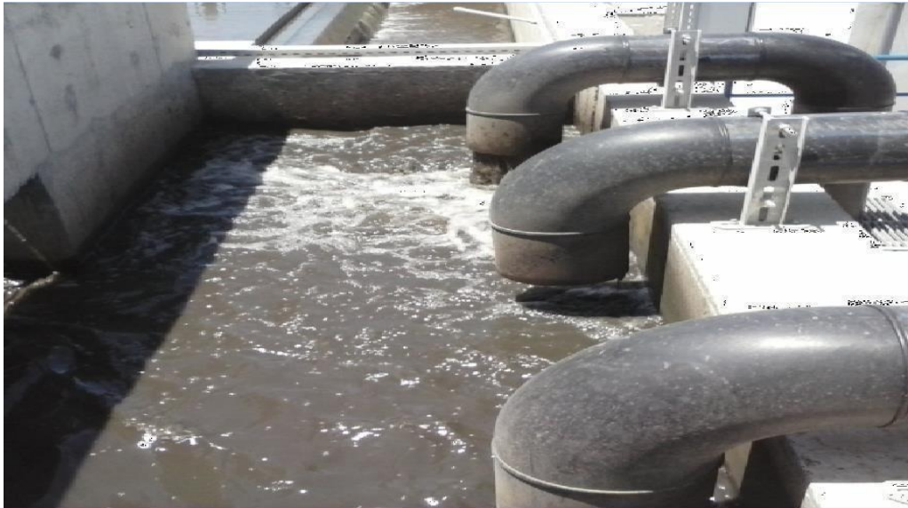
Figure II.8 : Bassin de recirculation des boues [15]
