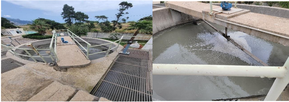
Figure II.5 : Séparation du sable et de la graisse [15]
