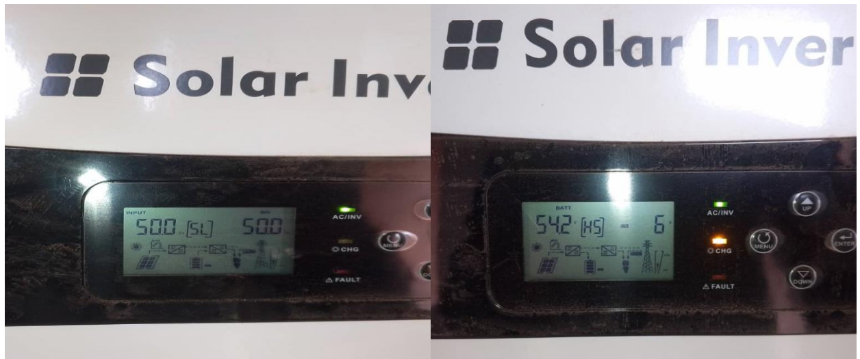
Figure III.15 : Les deux onduleurs en pleine fonctionnement
