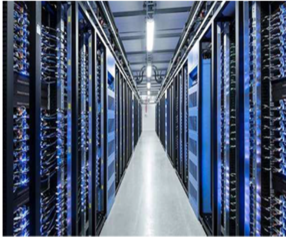
FIG. 1.2 – Exemple d'un Centre de données (Datacenter).
