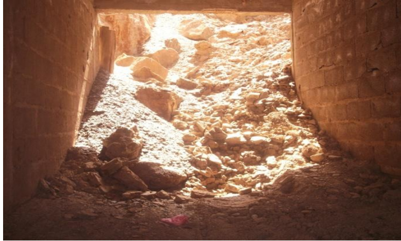
Figure III.04 : L'effondrement du toit de la galerie du filon N° 10 niveau 1855 m.
