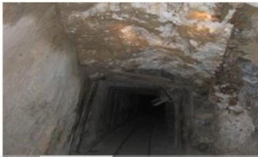
Figure I.04: Galerie d'exploitation souterraine de barytine (Algérie) [16].
