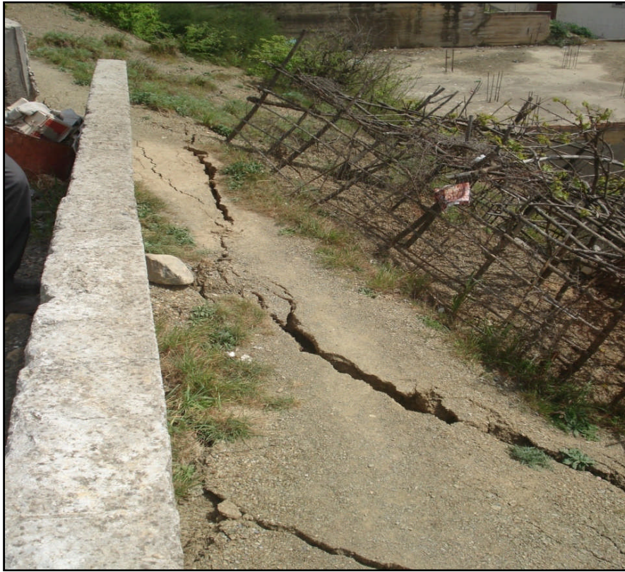
Figure I-6 : Photo montrant les fissures de traction
