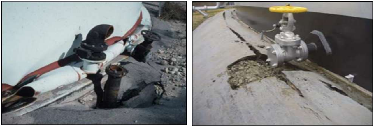
Figure I. 18. Rupture de la tuyauterie due à un tassement excessif [15].
