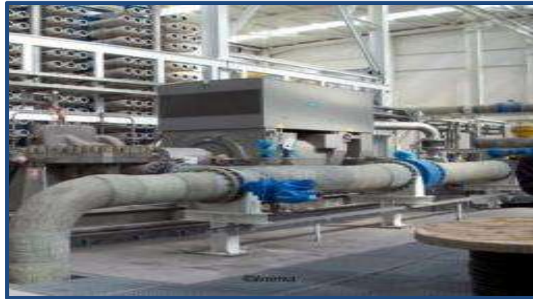
Figure IV.7 : Pompe à haute pression
