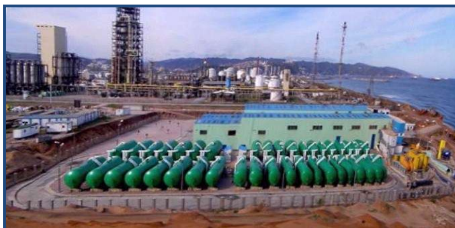
Figure IV.1 : Station de dessalement Cap Djinet
