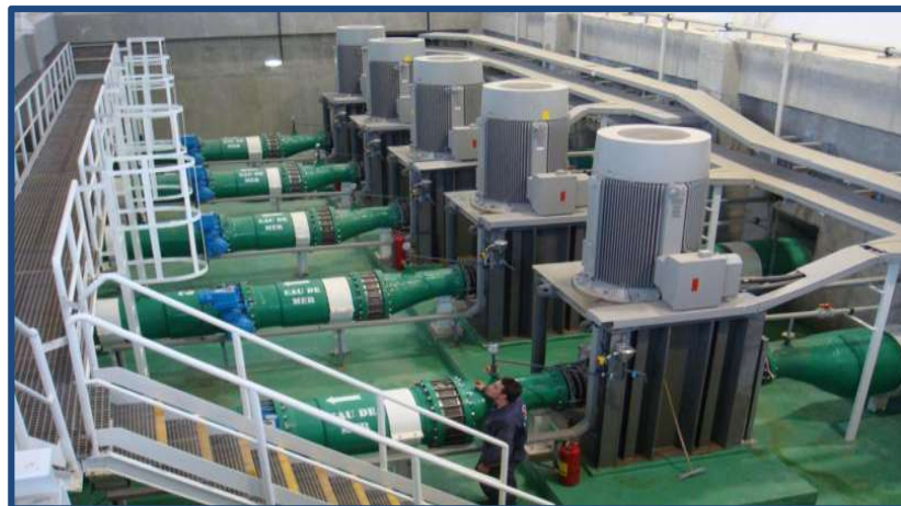
Figure IV.3 : Station de pompage de l'eau de mer
