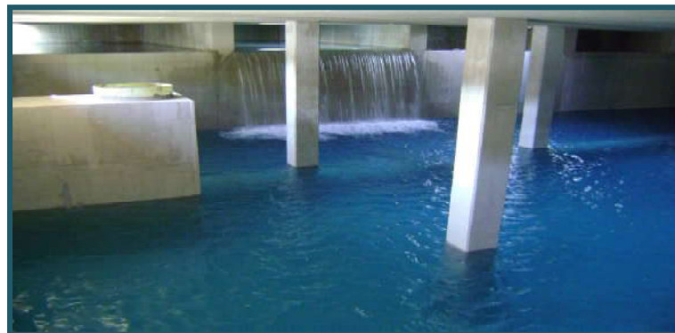
Figure IV.14 : Bâtiment de la saumure
