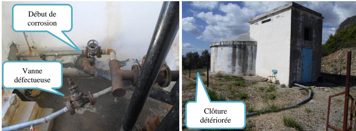
Figure (III.5): Etat du réservoir R3 N'TABLATE
