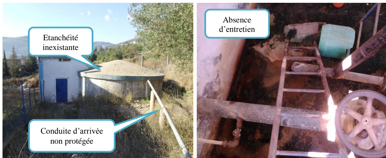
Figure (III.6): Etat du réservoir R4 d'EL-MERJ
