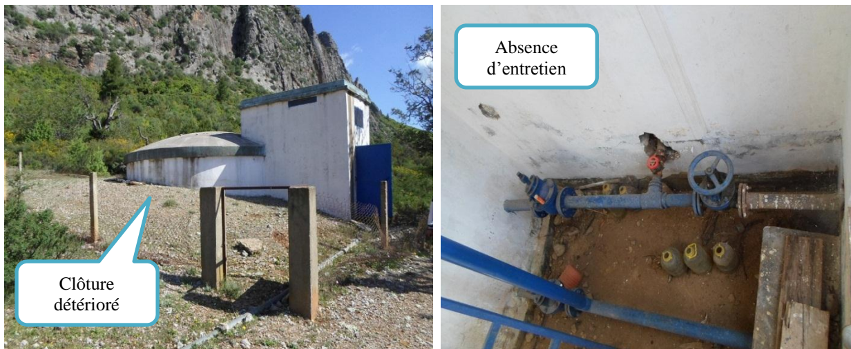
Figure(III.7): Etat du réservoir R5 de TIMANITHINE
