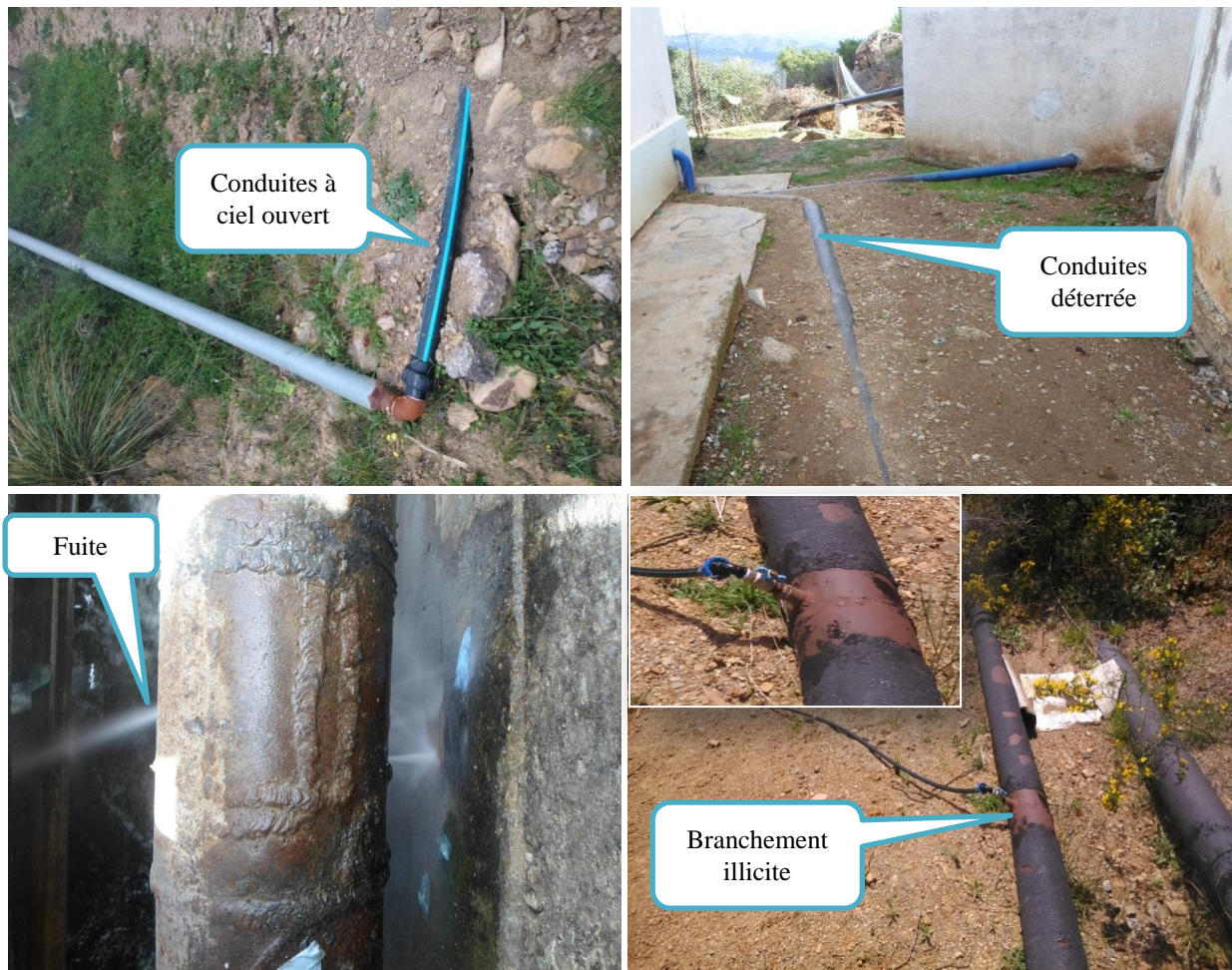
Figure (III.8): Etat des conduites
