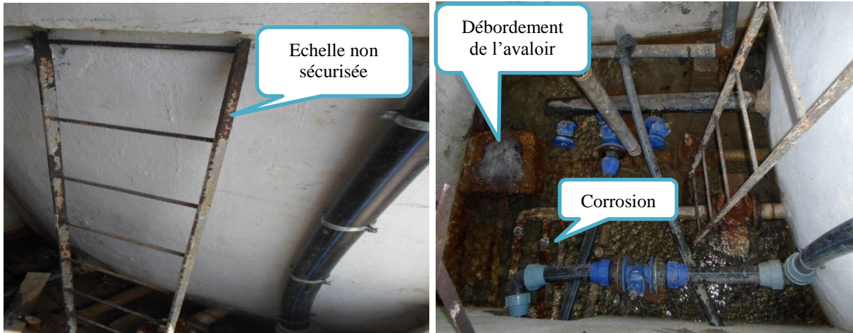
Figure (III.3): Etat du réservoir R1 d'EL-AINSER
