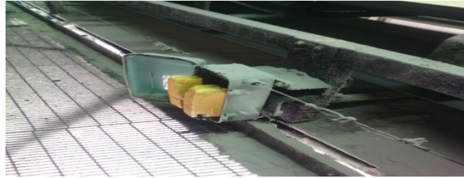
Figure II-12 : Arrêt d'urgence à câble
