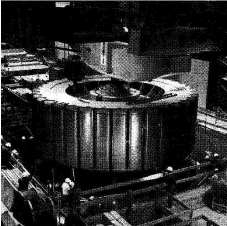
Figure III.8: Rotor à 36 pôles prêt à être placé à l'intérieur du stator; masse: 600 t ; moment d'inertie : 4140 \text{ t} \cdot \text{m}^2 ; entrefer : 33 mm, L'excitation de 2400
