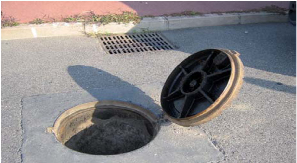
FIGURE 2.10 – Puits d'infiltration avec tampon(France).
