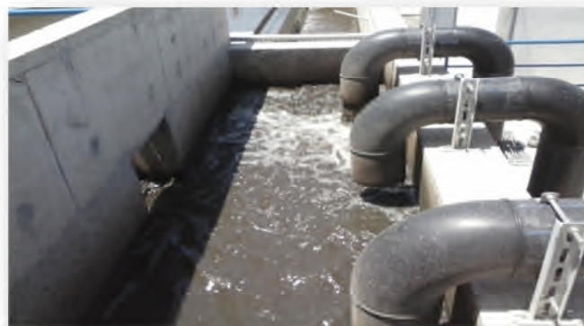
Figure 2.9: Bassin de recirculation des boues (Cliché par Arouche & Touil, 2018).
