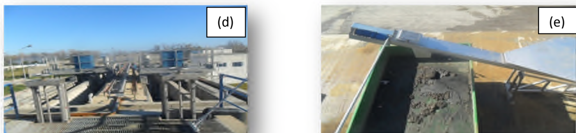
Figure 2.5: Pont déshuilage-dessablage (d) et Classificateur(e) (cArouche & Touil, 2018).
