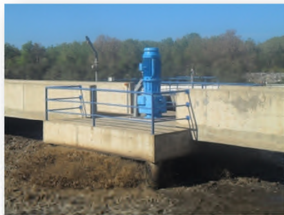
Figure 2.6 : Bassin d'aération (Cliché par Arouche & Touil, 2018).
