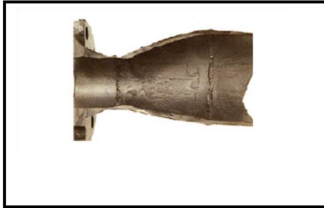
Figure I.8 : Corrosion-érosion dans une zone turbulente
