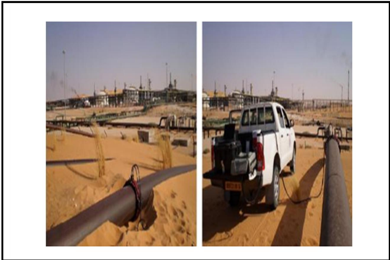
Figure (IV.4) : Détection la corrosion réalisée avec LRUT.
