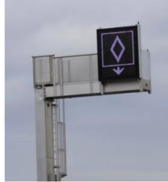
Figure 41 Panneaux de signalisation
