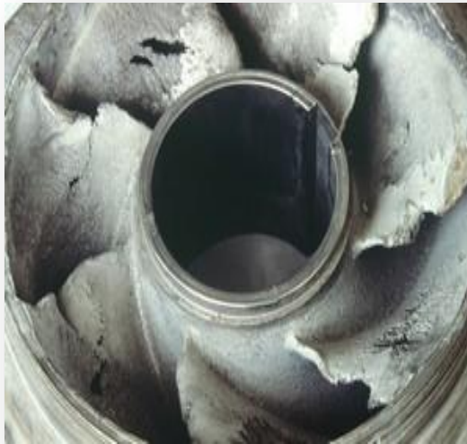
Figure (IV.3) : Photo illustrant le phénomène de cavitation sur des aubes d'une pompe centrifuge
